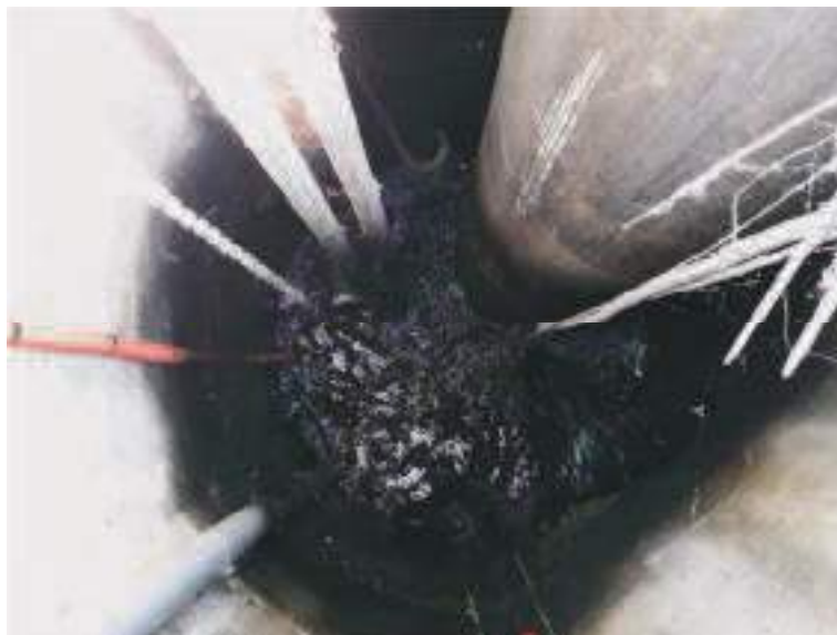
Figure 53 : Eaux dans le poste de relèvement de la Jonction
