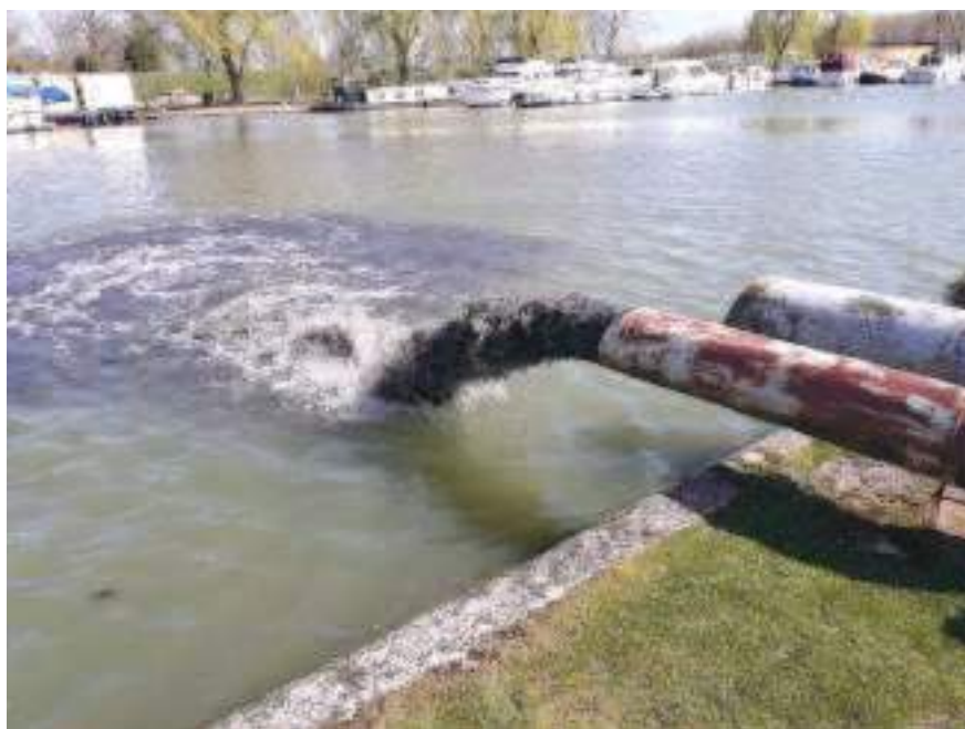
Figure 54 : Rejet du PR pluvial de la Jonction dans le port de Nevers
