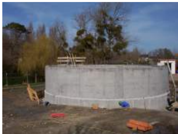
Figure 82a et b : Construction du poste de Mallouet et de sa bache de sécurisation à GRANVILLE – Construction de la bache de sécurisation du poste de refoulement de Laffont à SAINT-PAIR SUR MER – Cliché SMAAG
