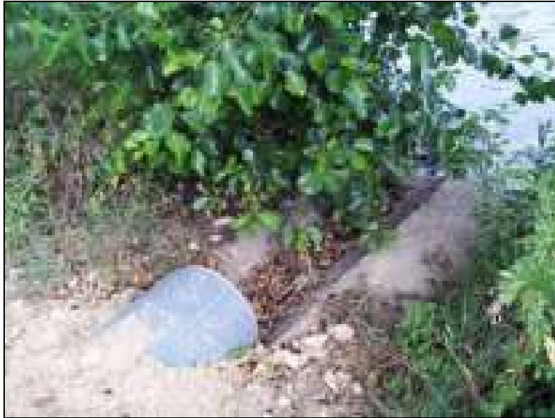
Photo 10 : Exutoire non identifié
